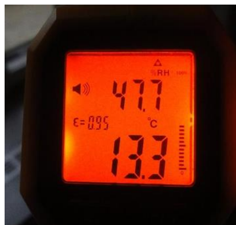
Temperatur Leibung Fenster EG (Heizung nicht in Betrieb)
